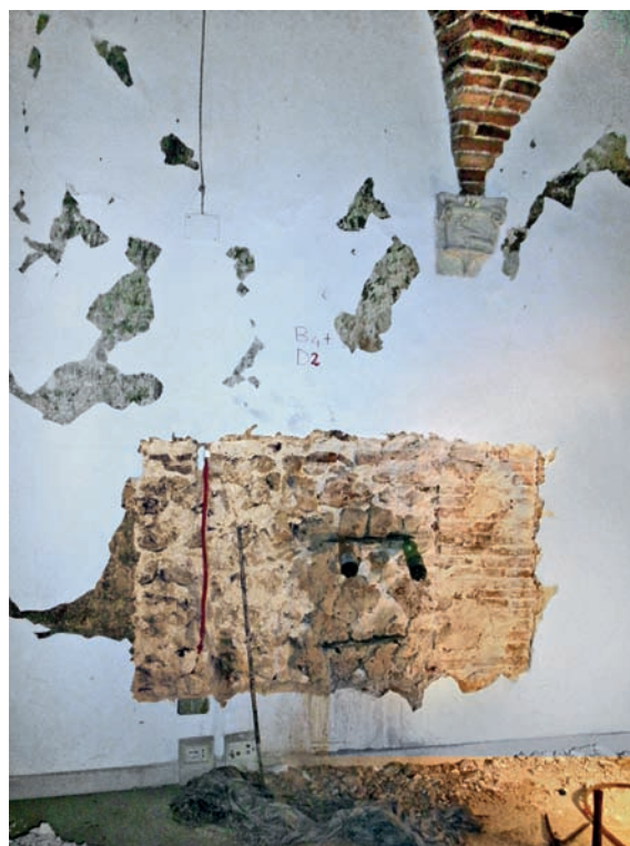
FIGURA 8 • Prova con martinetti piatti nel palazzo Carli-Benedetti dell'Aquila. La prova, appena conclusa (si sta raccogliendo il liquido residuo utilizzato per sollecitare i piatti metallici inseriti nella parete e si osservano le lesioni determinate dallo schiacciamento) è stata realizzata in un tratto di muratura in pietrame pertinente la fase quattrocentesca della fabbrica, durante la quale sono state rifu- se e soprelevate alcune cellule medievali. Il saggio è stato integrato con un'endoscopia effettuata in alto a sinistra della muratura, così da aggiungere informazioni sulla composizione interna della stessa.
