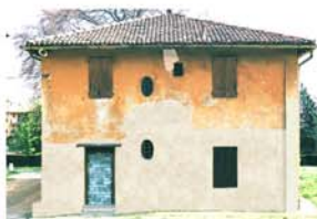
Simulazione della realizzazione di rappezzi, stuccature ecc., e della stesura di un intonaco leggermente tonalizzato nella parte basamentale della facciata.
